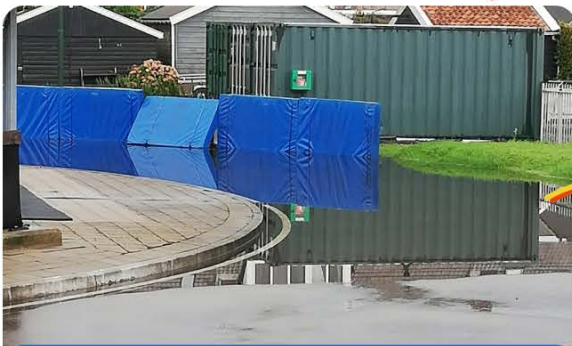
De baan blijkt te verzakken, zodanig dat bij een hoog waterpeil de baan onder water blijft staan. Ooit heeft op deze plek een sloot gezeten.
